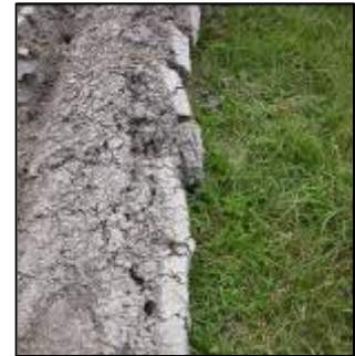
Photo 4 : Bande trop épaisse en bordure de fossé
